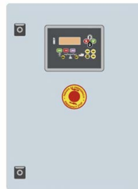
Внешний шкаф автоматического ввода резерва КОНТРОЛЛЕР СЕС7
